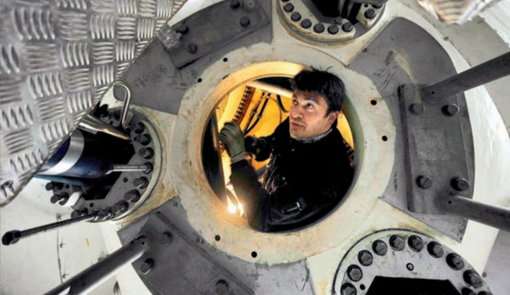
Tief drin: Elektriker Sascha Jacobsen inspiziert aus einer Rotornabe heraus die Pitchsysteme einer V80. Bei der Qualität der durchgeführten Arbeiten liegt der Wartungsdienst seines Arbeitgebers im Urteil der Kunden bei Gut - auch Dank fester Zuordnung einzelner Serviceteams pro Turbine.
