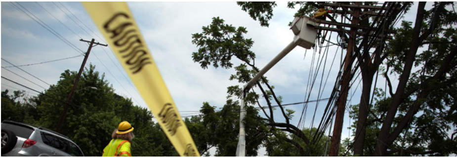
Durch einen Sturm beschädigte Stromleitungen im US-Bundesstaat Maryland
