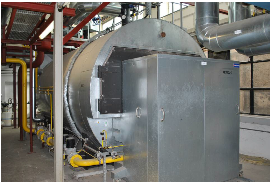
Kessel der Heizungsanlage
